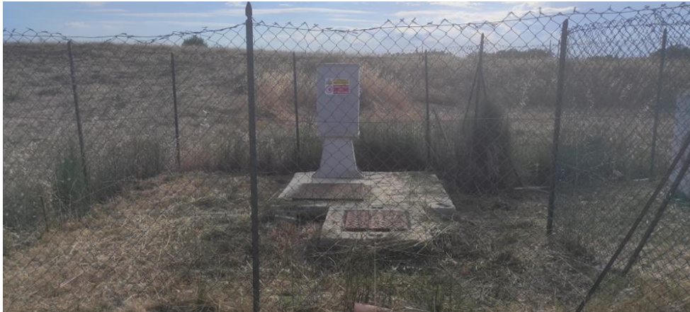
1) Tratto B-D nel punto C: presenza stazione di sollevamento acque nere
