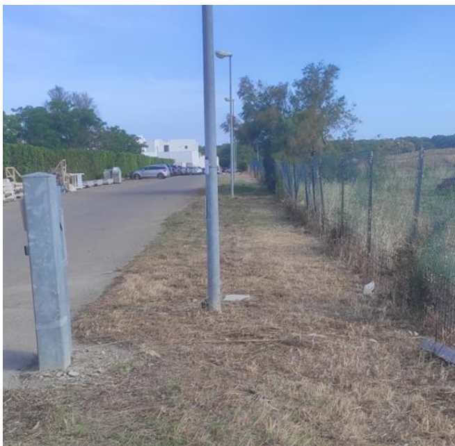
6) Impianto di illuminazione al centro del percorso
