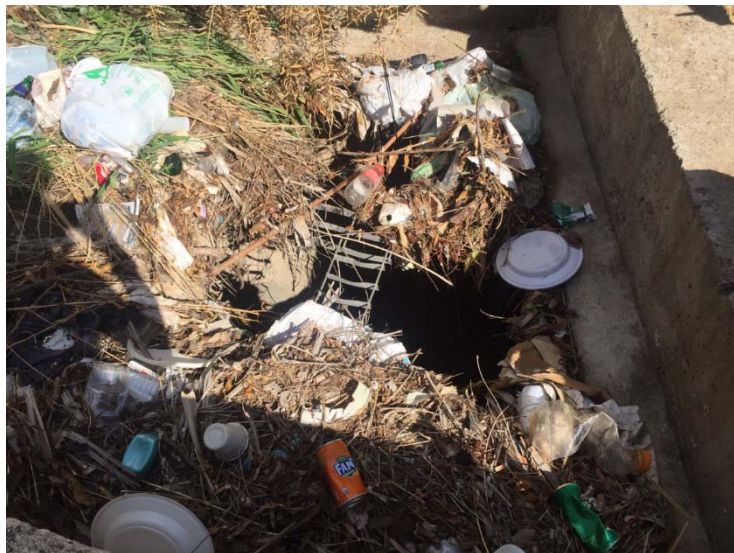
Fig. 4.4: pozzetti con griglia – Via Matera
