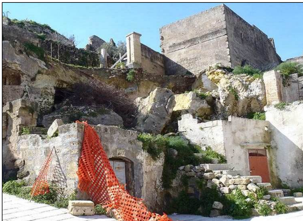
Fig. 26: Crollo in Via San Giovanni (situazione pre e post crollo)
