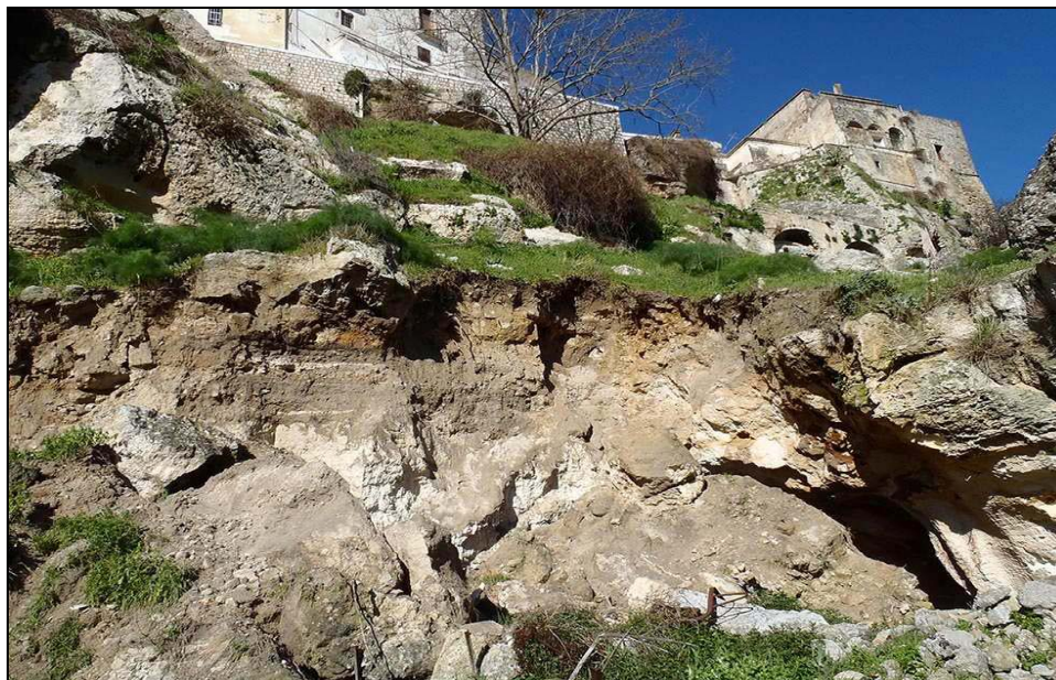
Fig. 28: Ginosa, villaggio Rivolta: sprofondamento connesso a cavità antropica (rapporto CNR IRPI, 2014)
