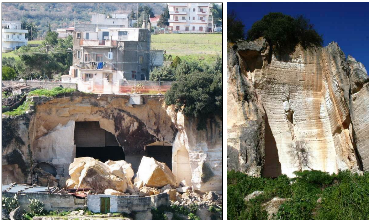
Fig. 19: Dissesti su Via Pescarella: crollo ingresso cava (sinistra) - fratturazione ammasso roccioso (destra)
