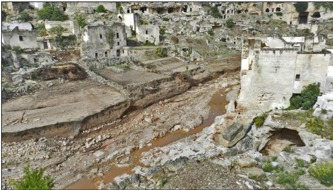
Fig. 23: Alluvione di Ginosa: scalzamento al piede delle sponde (2013)
